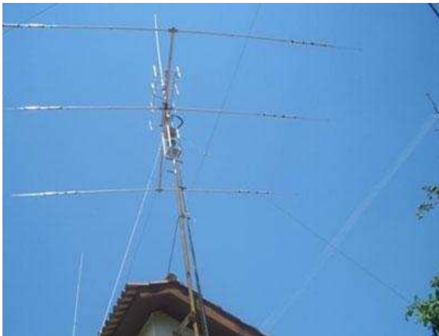
Ilustração 18 – Antenas: hf TH3mk3, cúbica quadrada VHF, 2 yagui em fase UHF e uma vertical V/UHF colinear comet, ao fundo outra vertical colinear V/UHF Diamond
